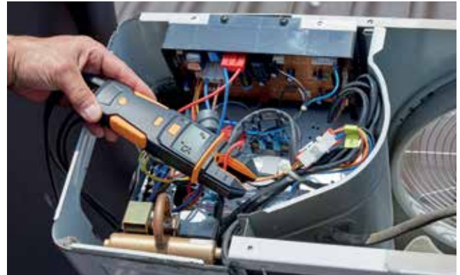
Измерение тока на наружном блоке кондиционера с testo 755 .
