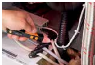
Первый тест подачи напряжения на компрессоре
