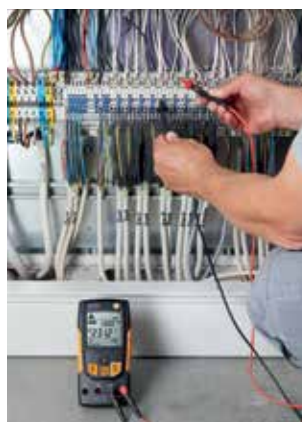
Проверка напряжения в распределительном щитке.
